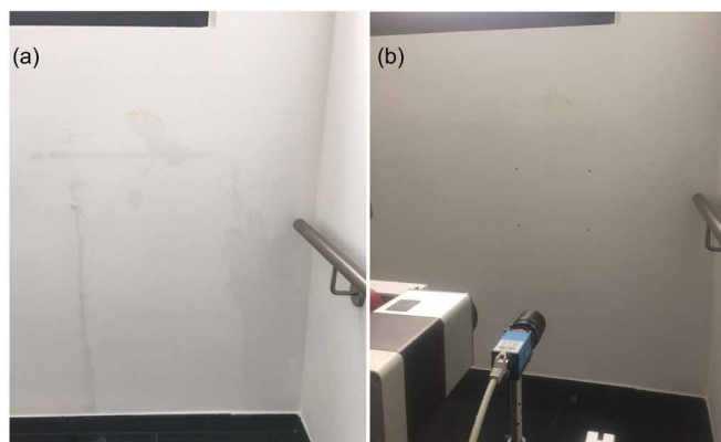
Abb. 9: Feuchteschaden Innenwand. (a) Aufnahme am Tag der Begutachtung der örtlichen Gegebenheiten, (b) Tag der Vermessung der Wandfläche
