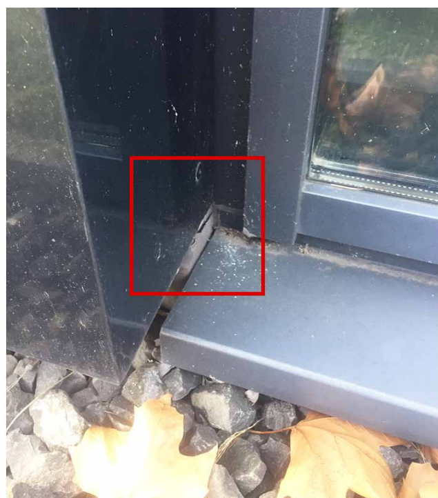
Abb. 11: Defekte Abdichtung an der Außenseite des Fensters
