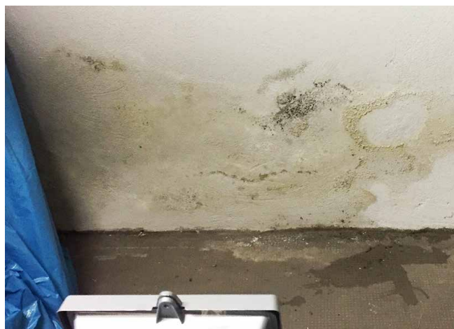
Abb. 5: Nasse Wandfläche mit Schimmel im Kellergeschoss eines Mehrfamilienhauses
